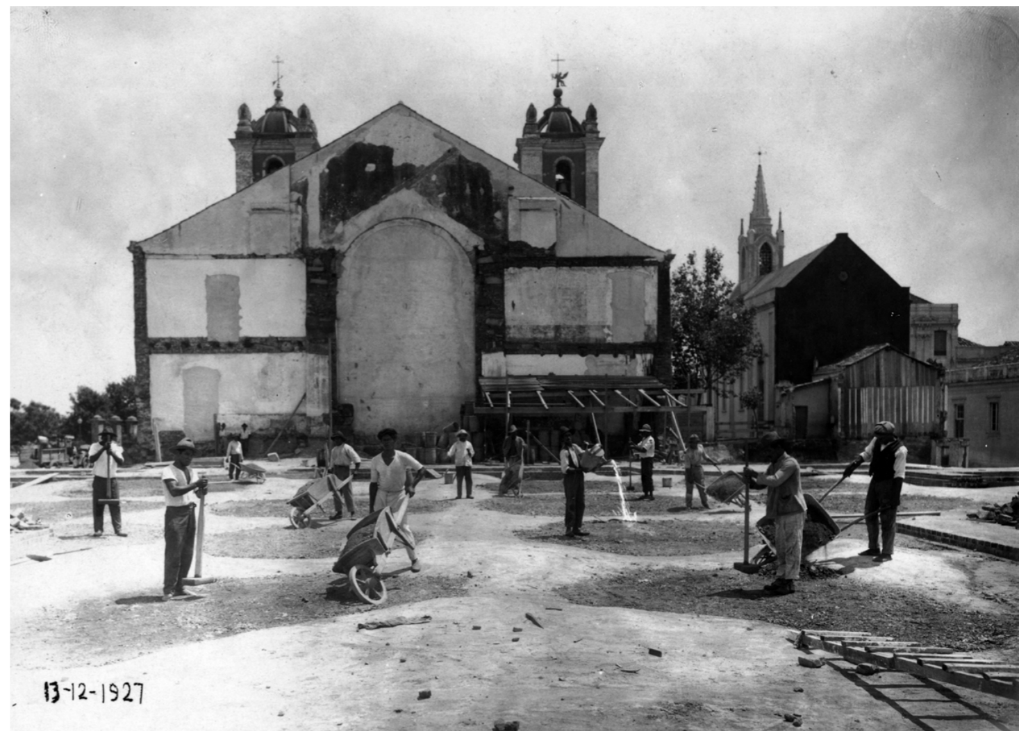
▼ Foto 69. [13/12/1927] No mês de novembro realizou-se a concretagem do forro e entrepiso da cripta, na qual o concreto da betoneira era derramado com carrinhos, espalhado e adensado manualmente com pilões. O canteiro de obra efervescia com a atividade e, em dezembro, os operários preenchiam com brita os vazios deixados pelas formas das abóbadas do forro.
