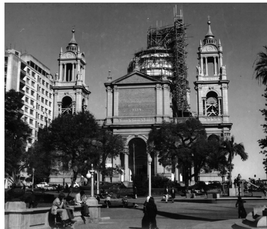
▲ Foto 113. Desde o início de 1972 as equipes trabalhavam no revestimento em placas de mármore da cúpula. Ao fundo, a estrutura de andaimes que serviam também para a instalação do zimbório. O revestimento de cobre dos telhados e abside leste ainda não havia sido executado. No frontispício, nota-se a ausência dos mosaicos que ainda não haviam sido instalados.
