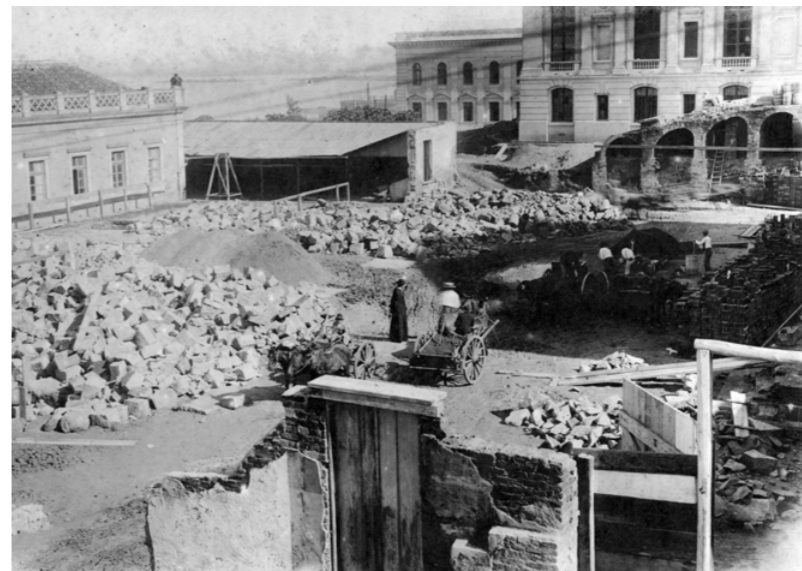
◀ DA ESQ. PARA DIR.: Foto 42. Em primeiro plano, a fundação de um dos pilares já concluída; em segundo plano, a fundação de outro pilar em execução.
